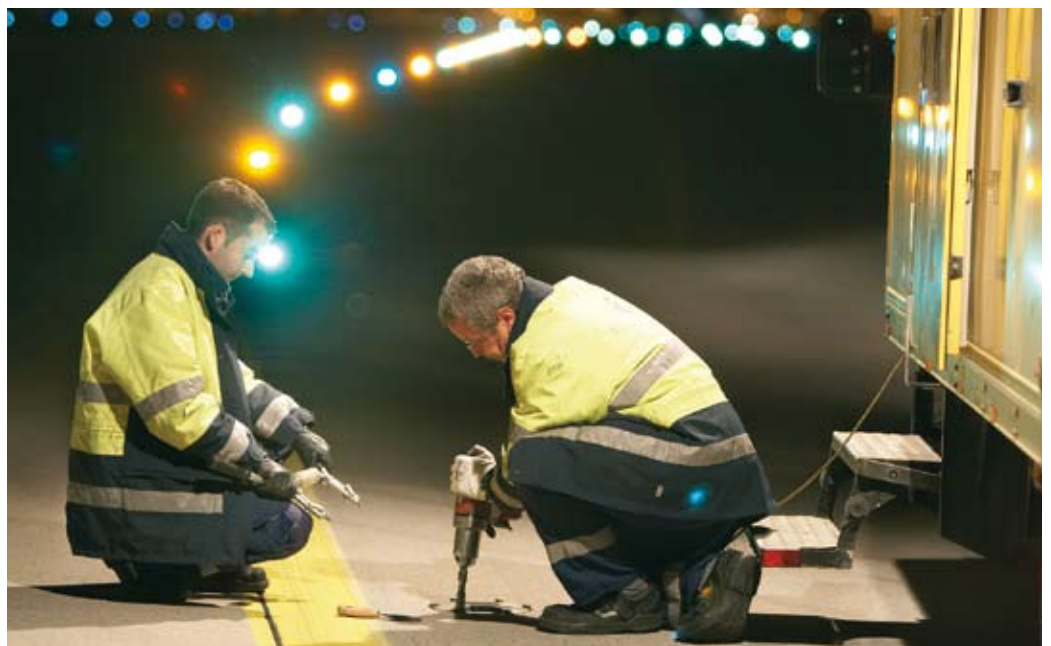
Ruck, zuck ersetzen Klaus Ocker (rechts) und Christian Strauß das kaputte Licht durch ein neues. Bevor die Elektriker sich an der Unterflurlampe zu schaffen machen, schalten sie den Strom am Verteiler ab.
