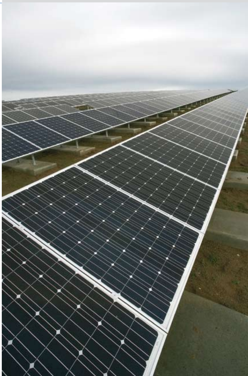
870.000 Kilowattstunden grünen Strom für das öffentliche Netz werden die Solarmodule auf dem Flughafen-Parkhaus produzieren.
