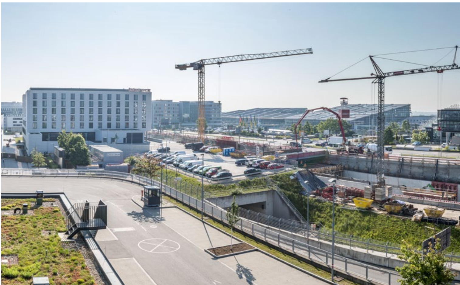
Kräne und Bagger im Einsatz in der Stuttgart Airport City: Hier entstehen das zweite Mövenpick-Hotel auf dem Campus sowie eine neue Haltestelle für die Stadtbahn U6.
