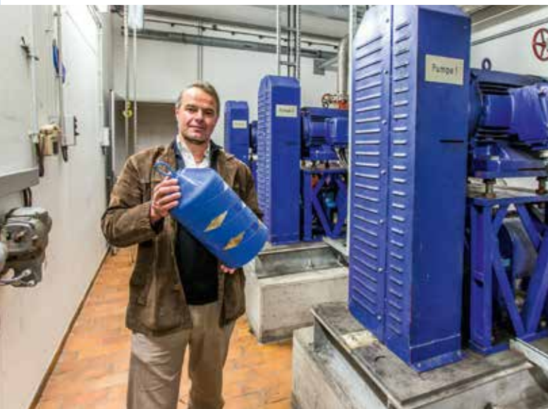
Abwassermanager Cornel Ritter säubert die Leitungen mit Molchen.
