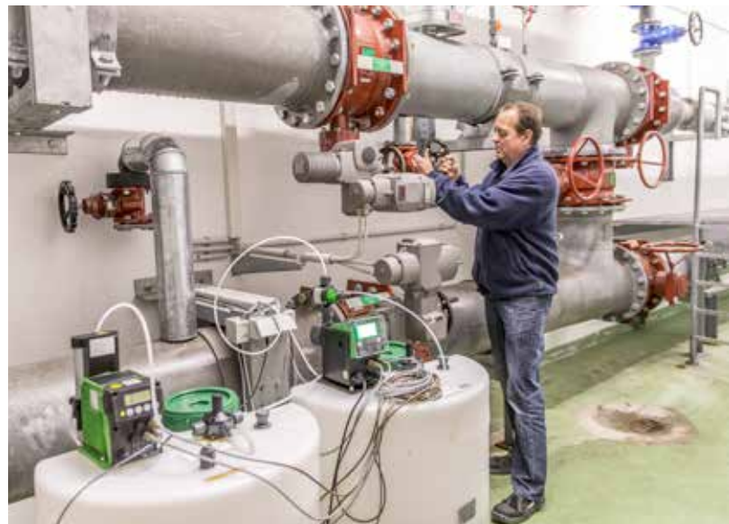
Große Leitungen sind nötig, um den Wasserbedarf am Flughafen zu decken. Werkstattleiter Siegbert Theurer checkt den Zulauf.
